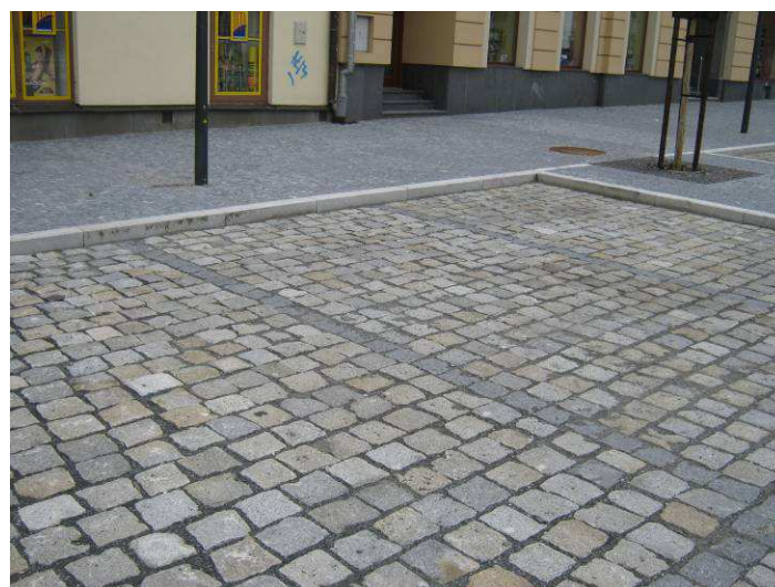
Autobusové zastávky (zálivy) a parkovací a odstavná stání vozidel - dlažba kamenná řádková velkoformátová.
