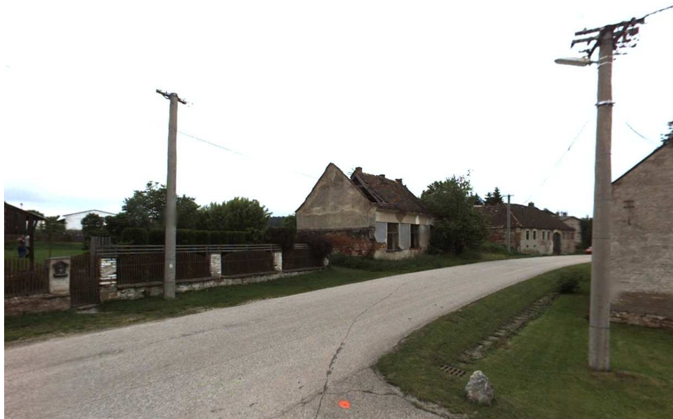
Západní část řešeného území - destruovaný objekt č. 7 při silnici II/409
