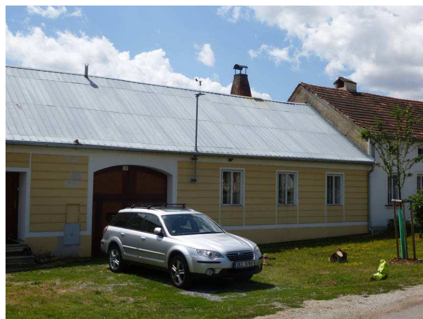
nevhodné použ. stř. krytiny č.p.26
