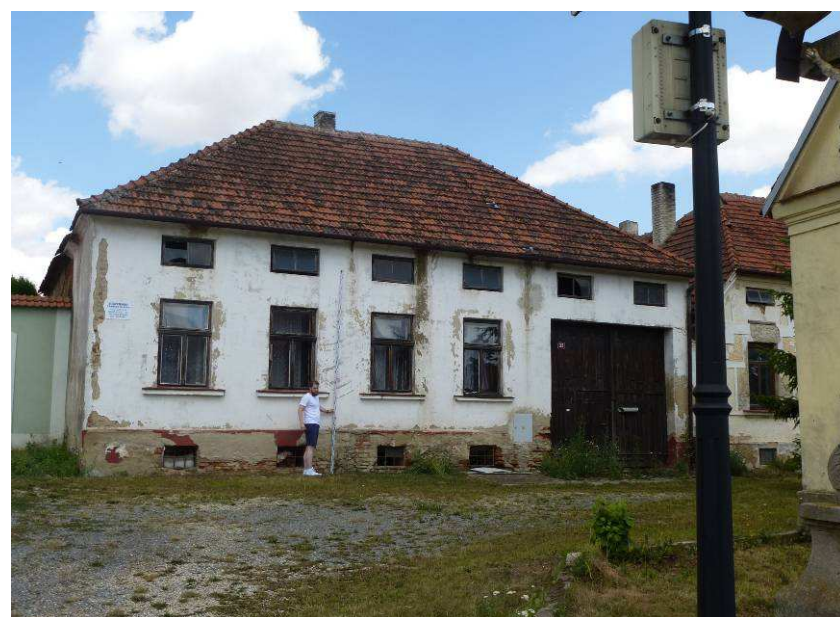
objekt bez údržby č.p. 33
