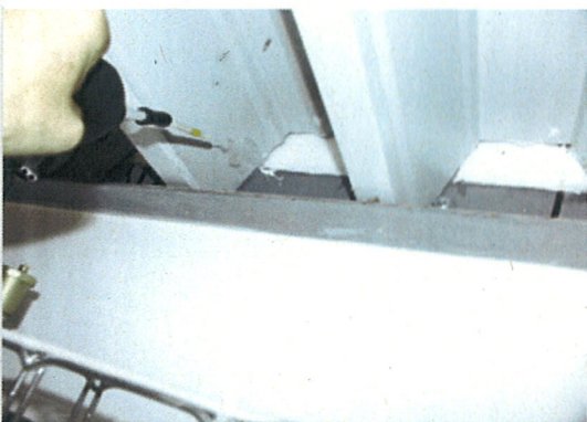
Netěsné rohy nad konzolemi u zakončení ▶ střešního pláště 4NP
