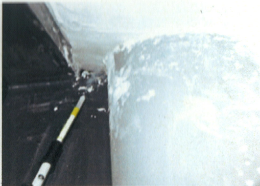
Velmi netěsné křídlo požárních dveří 4NP ▶
