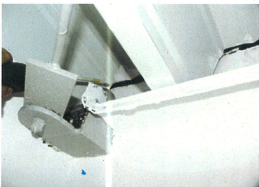
◀ Netěsná připojovací spára skrytá za snímatelným ostěním - JV roh 4NP
